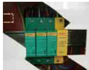
Nameščena II. stopnja prenapetostne zaščite v etažnem razdelilniku
